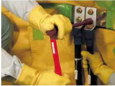
通信施設の電力工事での使用例
